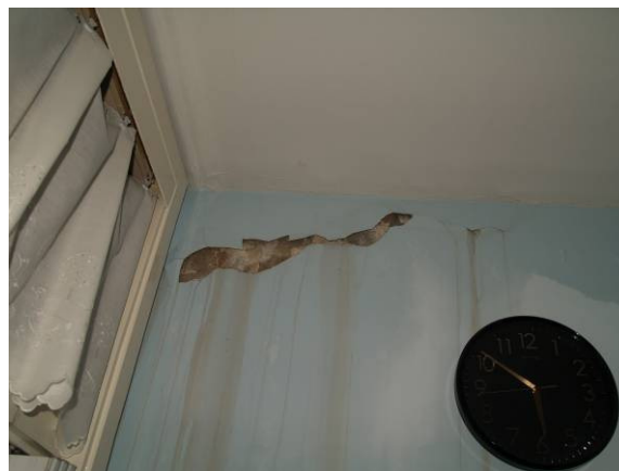
36 sz. kép. Oltóvíznyomok a tűzkeletkezés alatti, V. emeleti lakásban (fotó: Takács Lajos)
