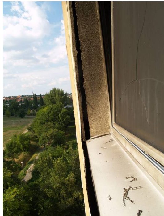
24 sz. kép. A park felőli homlokzat ablakkávájának képe. A hőszigetelő homlokzati bevonatrendszer nagy felületen elvált a fogadószerkezettől, az ablakkáva körül nincs üvegszövet, csak a 2x2 cm méretű festő élvédő (fotó: Takács Lajos)
