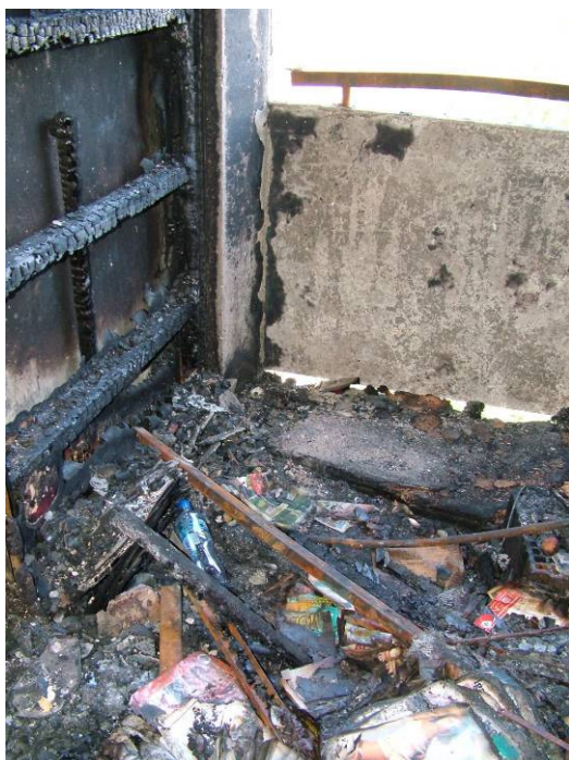
27 sz. kép. A VII. emeleti lakás loggiája. Jól látható a bal oldalon a loggia oldalsó burkolatának égett faváza, továbbá a mellvédfal és a padlóburkolat közötti 10 cm hézag (fotó: Miskolci Tűzoltóság)
