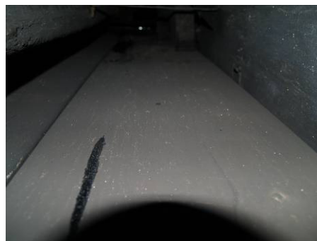
11-12. sz. képek. Az akna belső képe lefelé (fent) és felfelé (lent) a VII. emeleti lakásból. Jól látható, hogy semmilyen, tűzterjedést megakadályozó lehatárolás nem készült a födémek vonalában (fotó: Takács Lajos)
