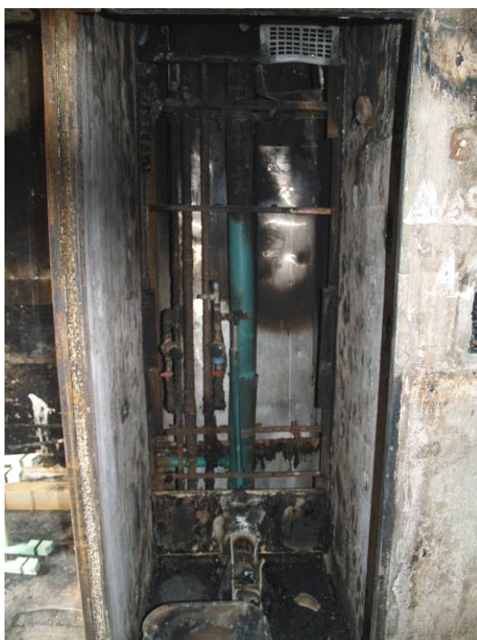
10. sz. kép. A WC helyiség képe a tűzkeletkezés helyén, a VI. emeleten. Jól látható, hogy az akna elhatárolása megsemmisült, a hő és a füst a szellőzők között akadálytalanul áramlott be az aknába (fotó: Takács Lajos)
