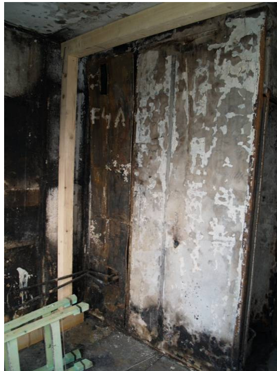
5 sz. kép. A fürdőszobai térelem a VI. emeleti lakás konyhája (a tűzkeletkezés feltételezett helye) felől nézve, már a lakás dúcolása után. Bal oldalon a fémlemez aknafal (fotó: Takács Lajos)
