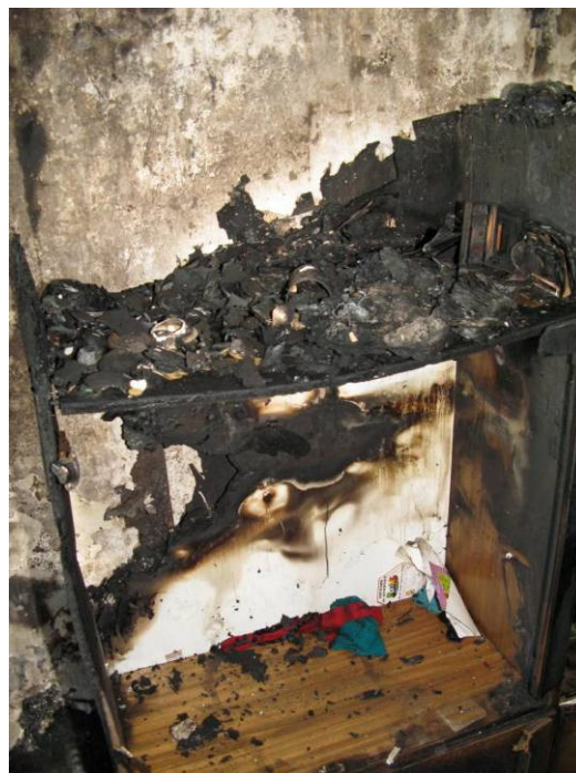
28 sz. kép. Jellegzetes károsodás a VII. emeleti lakásban: az égésnyomok a loggia felől emelkednek, ami bizonyítja, hogy a tűzterjedés a loggia felől következett be (fotó: Király András)
