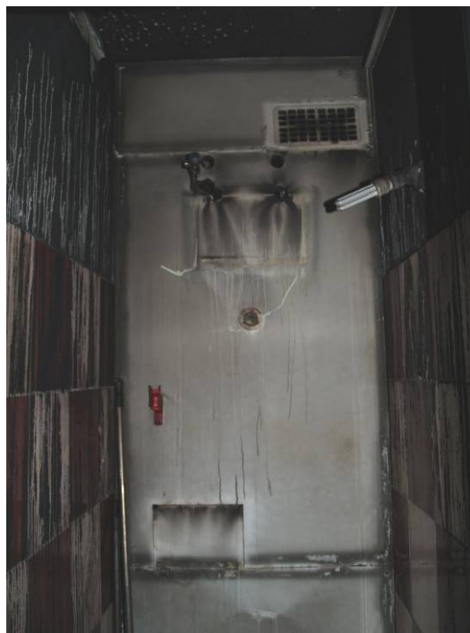
18 sz. kép. A IX. emeleti lakás WC hátfala. Itt is leszakadt a WC tartály, de megmaradt a revíziós ajtó (fotó: Takács Lajos)
