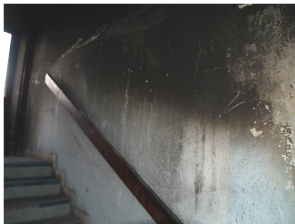
32 sz. kép. A lépcsőház képe a tűzkeletkezés szintjén, a VI. emeletről az VII. emeletre, felfelé vezető kar mentén (fotó: Takács Lajos)
