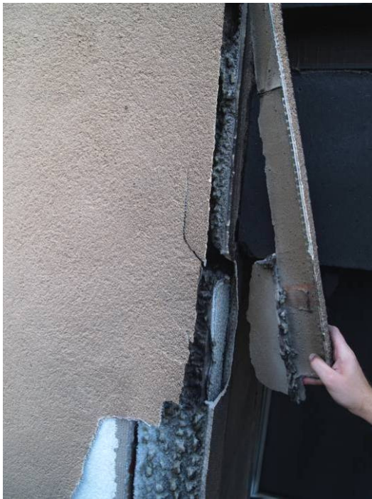
23 sz. kép. A homlokzati hőszigetelő bevonatrendszer ablakká kiképzése a Középszer utcai homlokzat VIII. emeletén. Jól látszik az üvegszövet hiánya és a festő élvédő alkalmazása (fotó: Takács Lajos)
