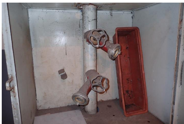
11. ábra Elhanyagolt száraz felszálló tűzivízvezeték
