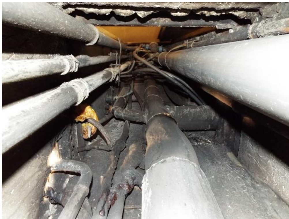
12. kép A strang szerelvények aknája akadálytalanul biztosította a tűz függőleges terjedését. Fotó: Farkas – Bozsik Gábor
