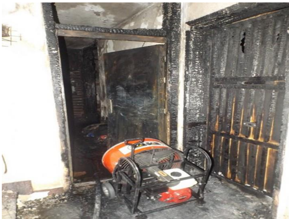
10. kép A vízszintes tűzterjedés által meggyulladt bejáratí ajtó. Fotó: Farkas-Bozsik Gábor
