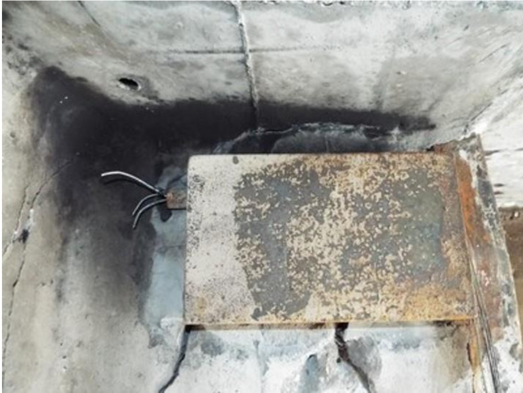
11. kép A biztosítéktábla fém ajtaján látható koncentrált hőhatás indította el a tűzvizsgálót a tűz keletkezési helyének felderítése fel Fotó: Farkas - Bozsik Gábor
