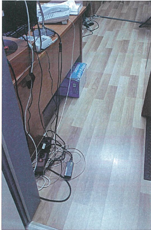
7. kép Nem megfelelően elhelyezett kábelek
